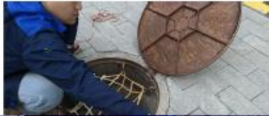
废水：生活污水排放口
